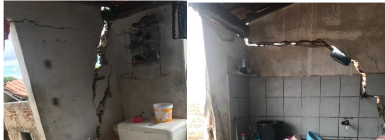
Figura 4 - Brechas nas paredes laterais da cozinha.
