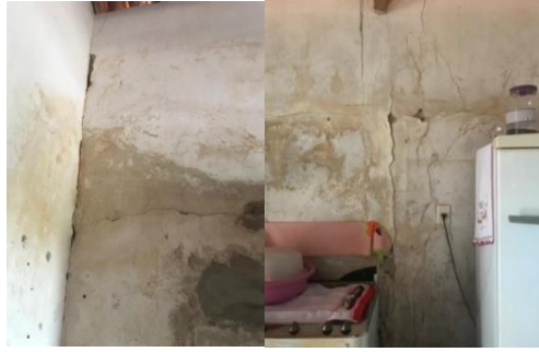
Figura 3 - Trincas nas paredes laterais da cozinha.
