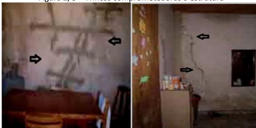
Figura 2, 3 – Trincas comprometedoras à estrutura
