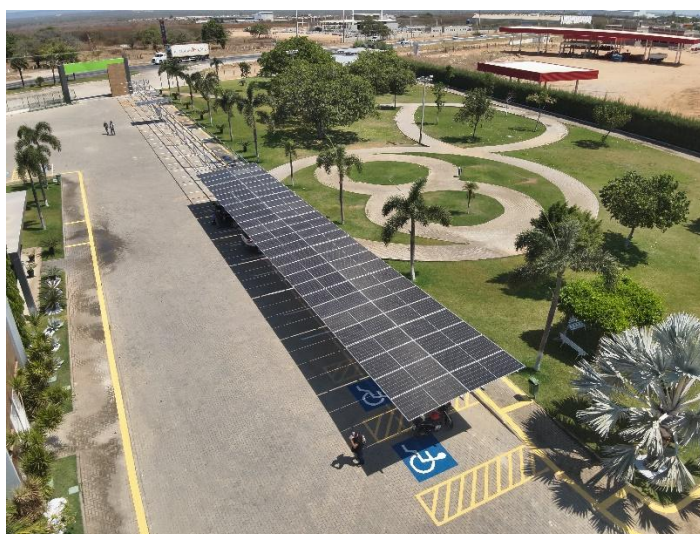
Figura 13. Usina fotovoltaica instalada (autoria própria).
