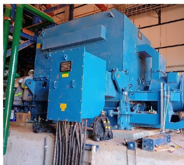
Figura 2.1: Local da Instalação do Gerador.
