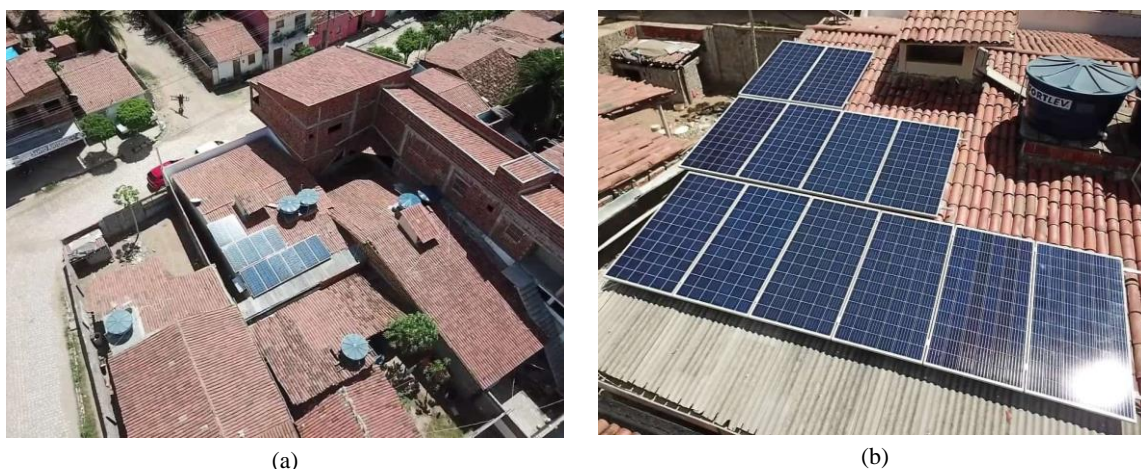
FIGURA 11. Local de instalação do sistema fotovoltaico 7: (a) Geral; (b) Aproximado.
