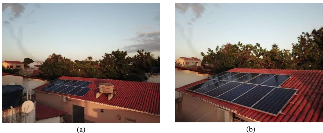
FIGURA 10. Local de instalação do sistema fotovoltaico 5: (a) Geral; (b) Aproximado. Fonte: [11].
