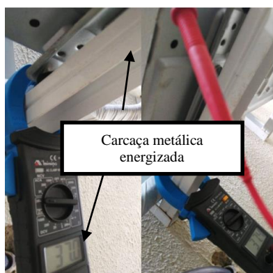
FIGURA 4. Energização das carcaças do ar-condicionado Fonte: Autoria própria, 2021.
